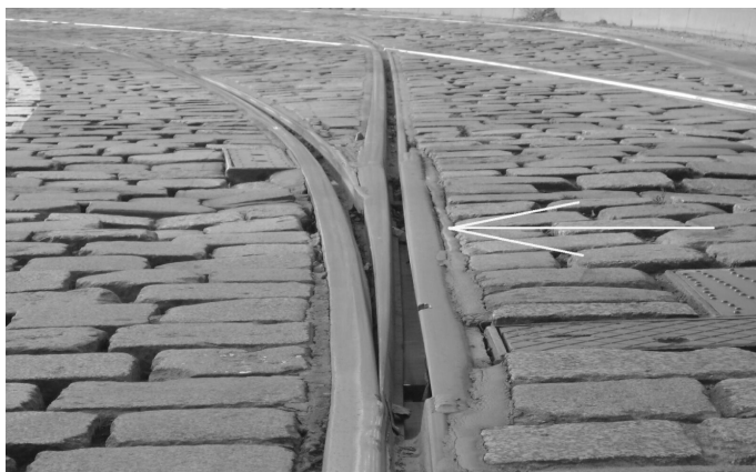
Fot. 6. Przewężenie prześwitu w lewym toku szynowym
