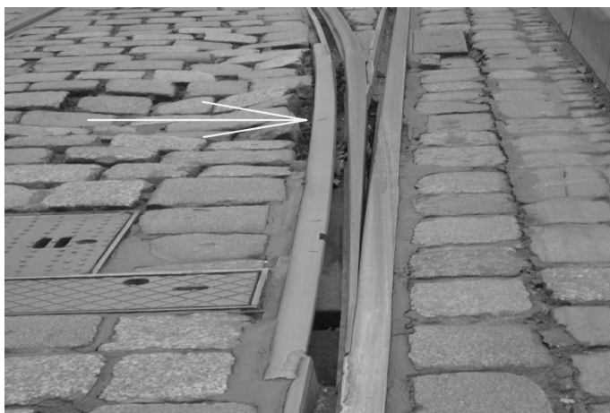
Fot. 5. Przewężenie prześwitu w prawym toku szynowym
