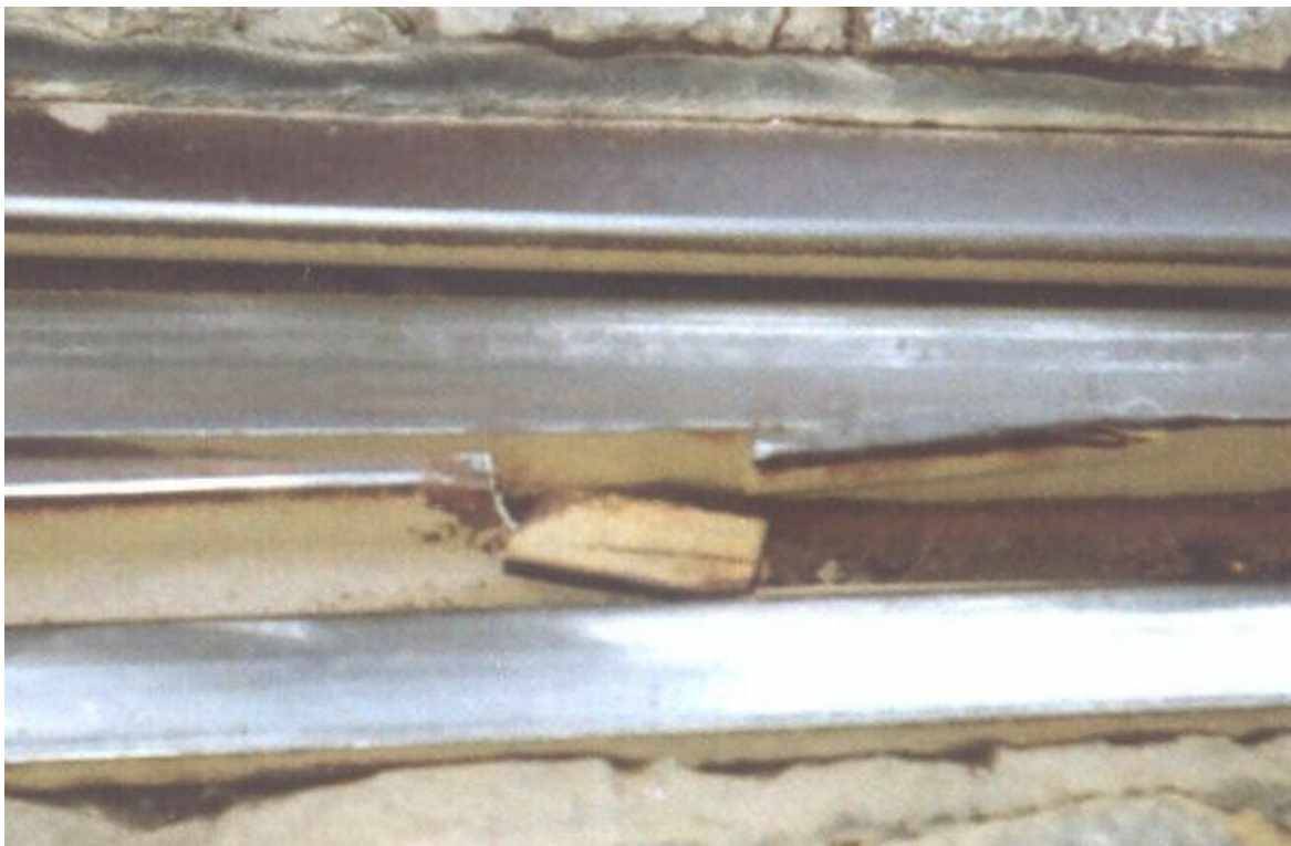
Fot.4 Wyłamany fragment dzioba opornicy
