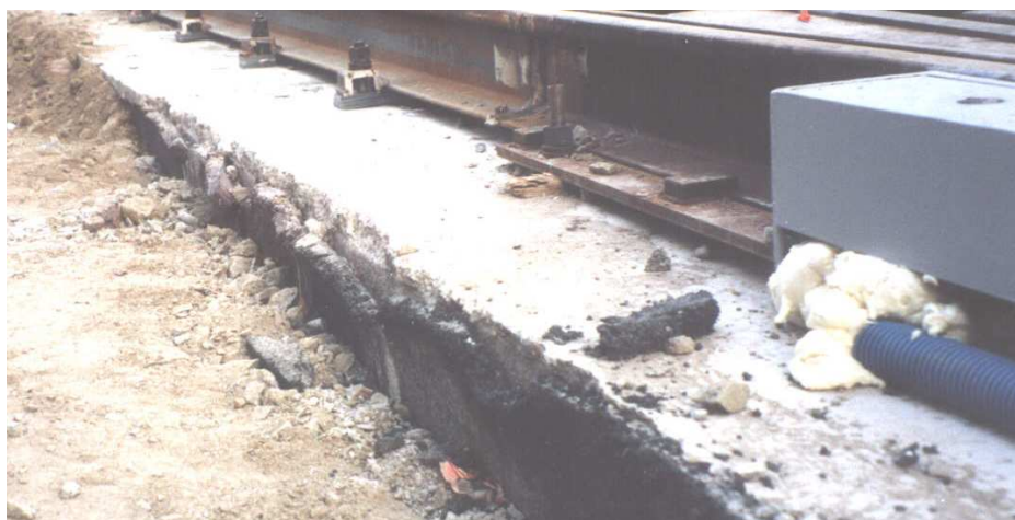
Fot. 6. Maty z granulatu gumowego i ich zniszczenie spowodowane brakiem betonowych oporów bocznych
