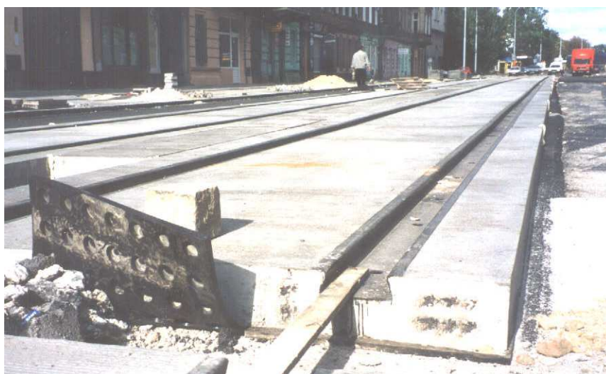
Fot. 2. Maty wibroizolacyjne z pełnej gumy z okrągłymi wydrążeniami umieszczone pod płytami toru węgierskiego
