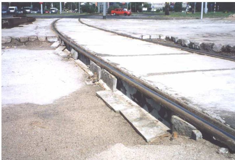
Rys.5 Wypadanie bloczków betonowych z komór szynowych (Wrocław - pl. Strzegomski, rok 2005)
